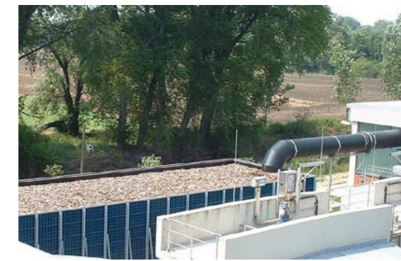
Offener Flächenfilter in Kunststoff-Bauweise
